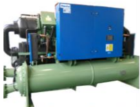
中央空调，空压机，冷柜，冷冻机
