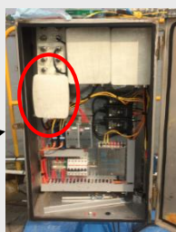
接入终端安装于AGV车内
